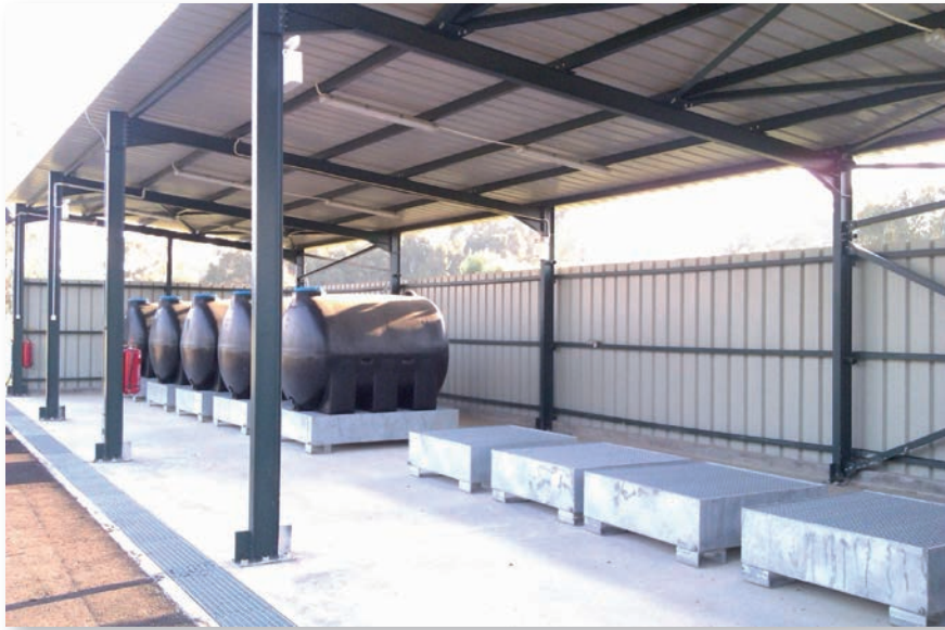
Εικόνα 8: Εγκατάσταση διαχείρισης αποβλήτων
