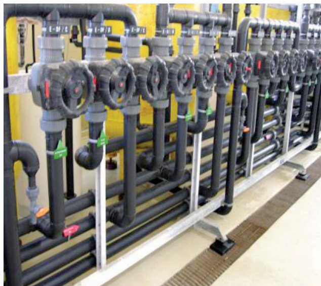
Εικόνα 5: Εγκατάσταση διαχείρισης αποβλήτων
