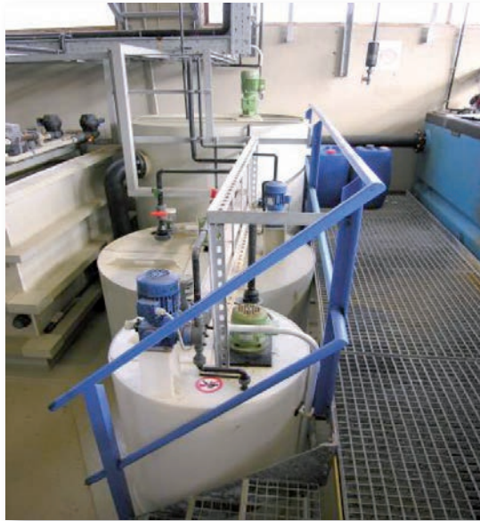
Εικόνα 6: Εγκατάσταση διαχείρισης αποβλήτων
