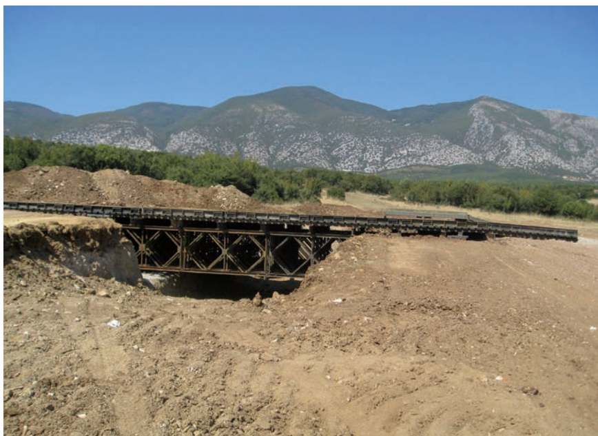
Εικόνα 19: Κατασκευή Γέφυρας τύπου «Bailey» στο Ρέμα Πτοκοκάκι στο Δ. Πυθαγορείου Σάμου (ΣΞ)
