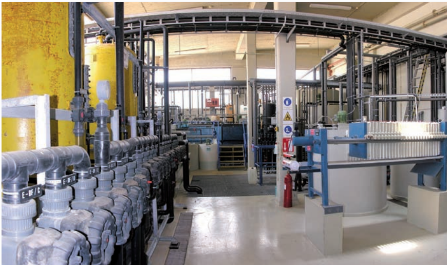
Εικόνα 7: Εγκατάσταση διαχείρισης αποβλήτων
